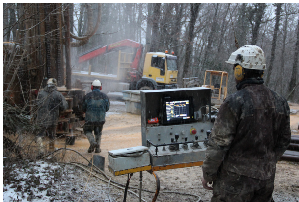
En janvier dernier, la Communauté de communes du Pays de Gex a réalisé un forage à Crozet. Celui-ci a confirmé la présence d'eau en quantité potentiellement importante. © CCPG
